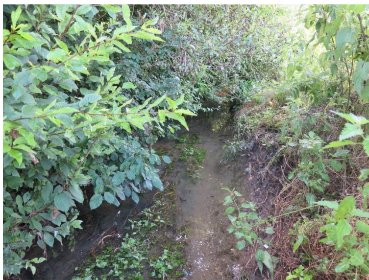
Abb. 17 Verschlammung der Sohle
